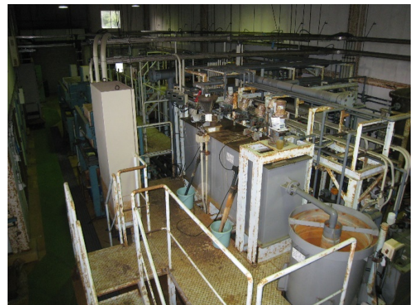
筑波大学無機廃液処理施設
