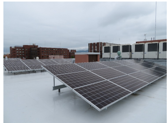
人間系学系 B 棟屋上太陽光パネル
