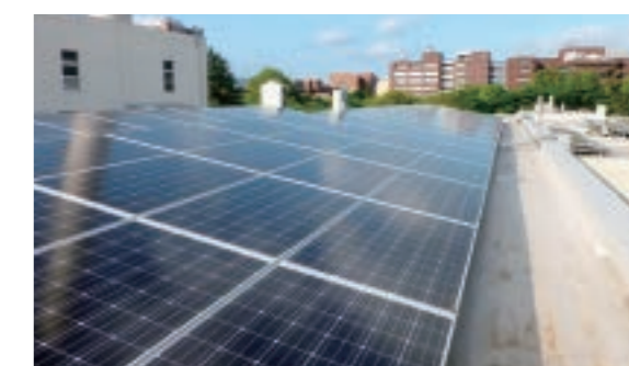
中央機械室屋上太陽光パネル
