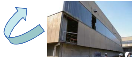
総合体育館の損壊状況 （震災当時）
