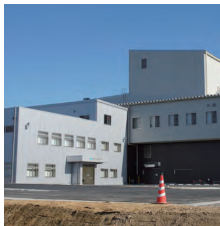
4月の稼働開始に向け、工事が進むリサイクルセンター(1月24日、つくば市水守で)
