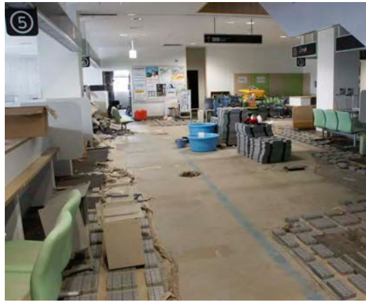
1階部分が浸水し、床のタイルがはがれた常総市役所 (9月21日、常総市水海道で)
