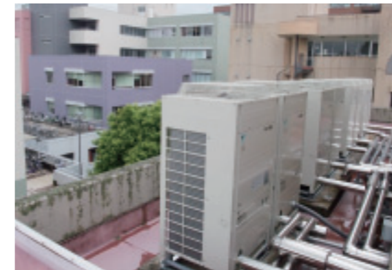
1H棟の個別空調機用室外機
