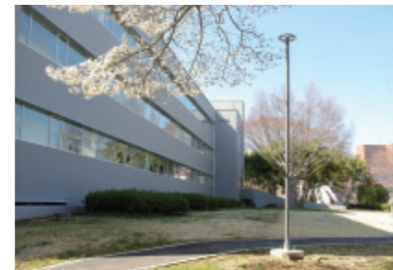
第一エリアLED外灯
