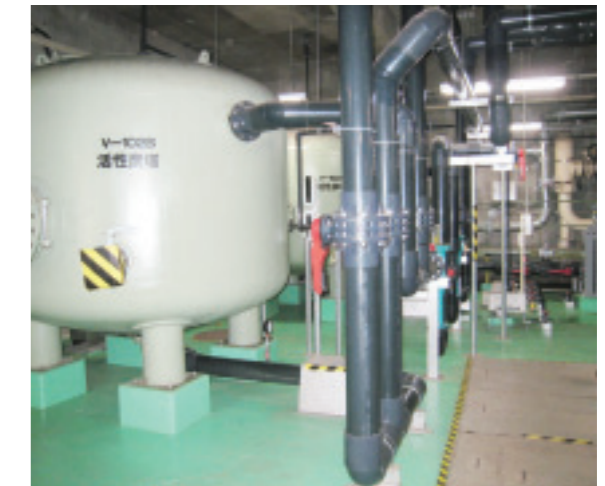
活性炭吸着塔
