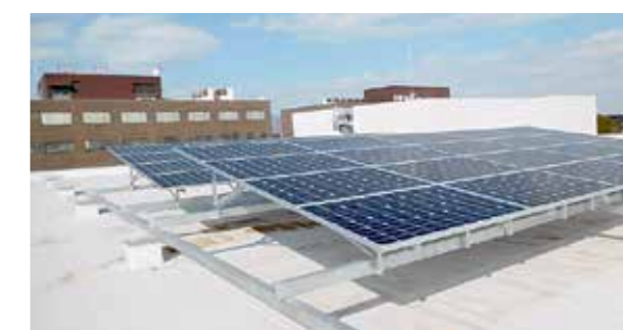
グローバルスポーツインベーション棟屋上太陽光パネル
